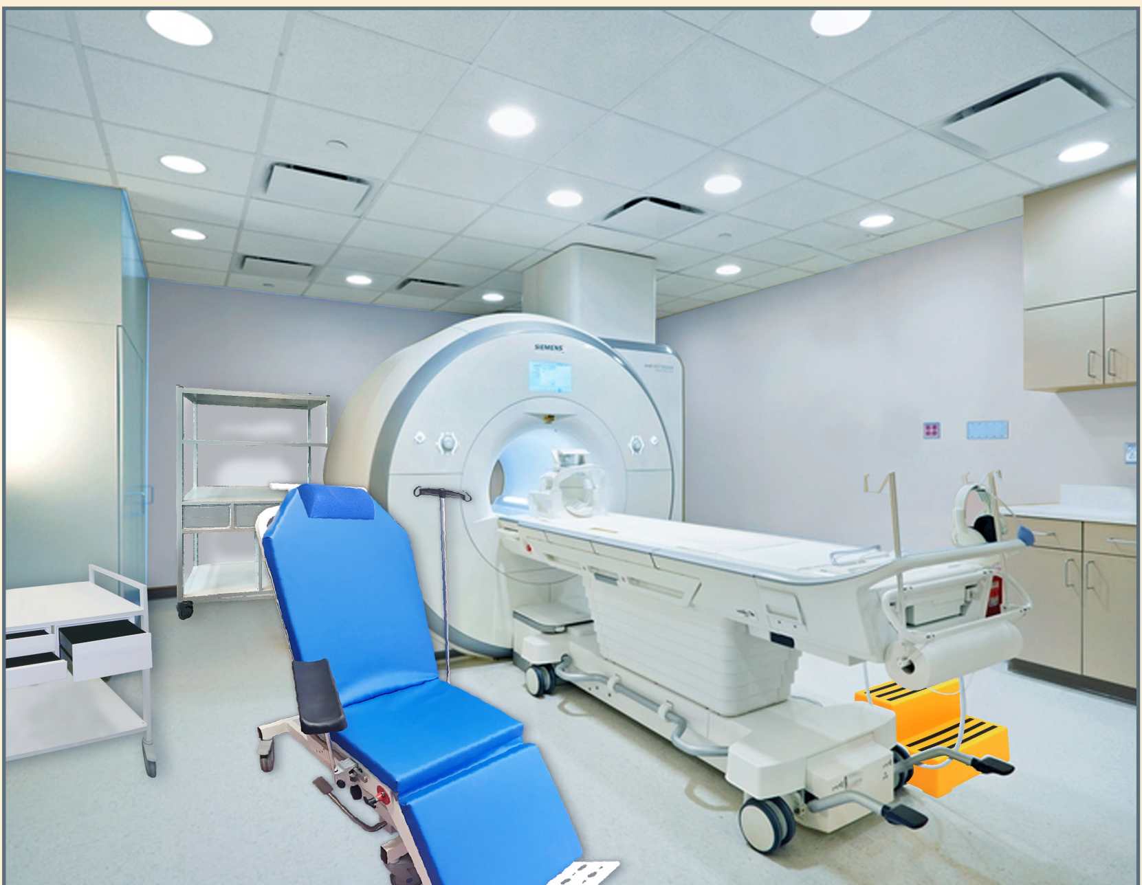
Equippement d'une Salle SIEMENS
